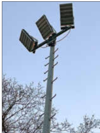
Eine detaillierte Ansicht der dreigeteilten LED-Flutlichter. Jedes einzelne Element kann separat angesteuert und gedimmt werden.
